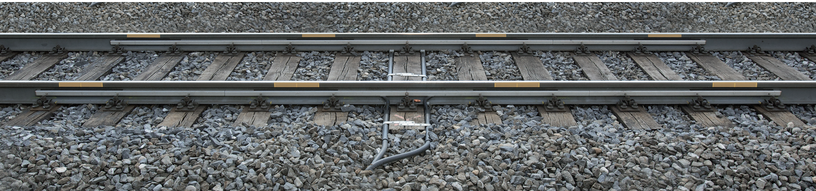
DYNARAIL avec 8 capteurs, traverses en bois
