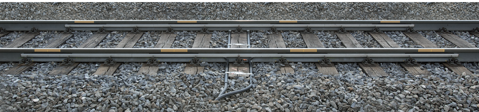
DYNARAIL con 8 sensori, traverse di legno
