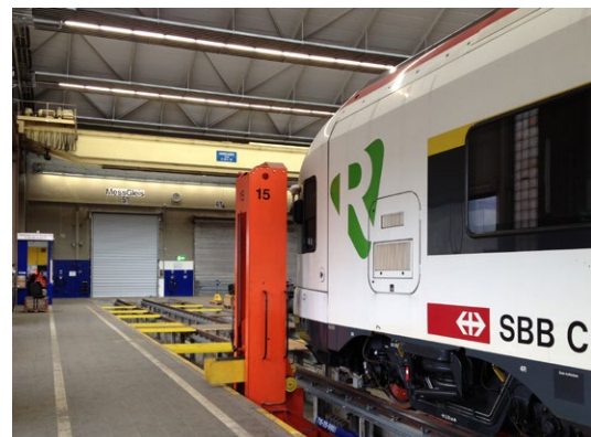
WILOC dans une voie de mesure relevée
